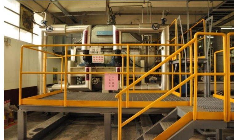
污泥乾燥設備
