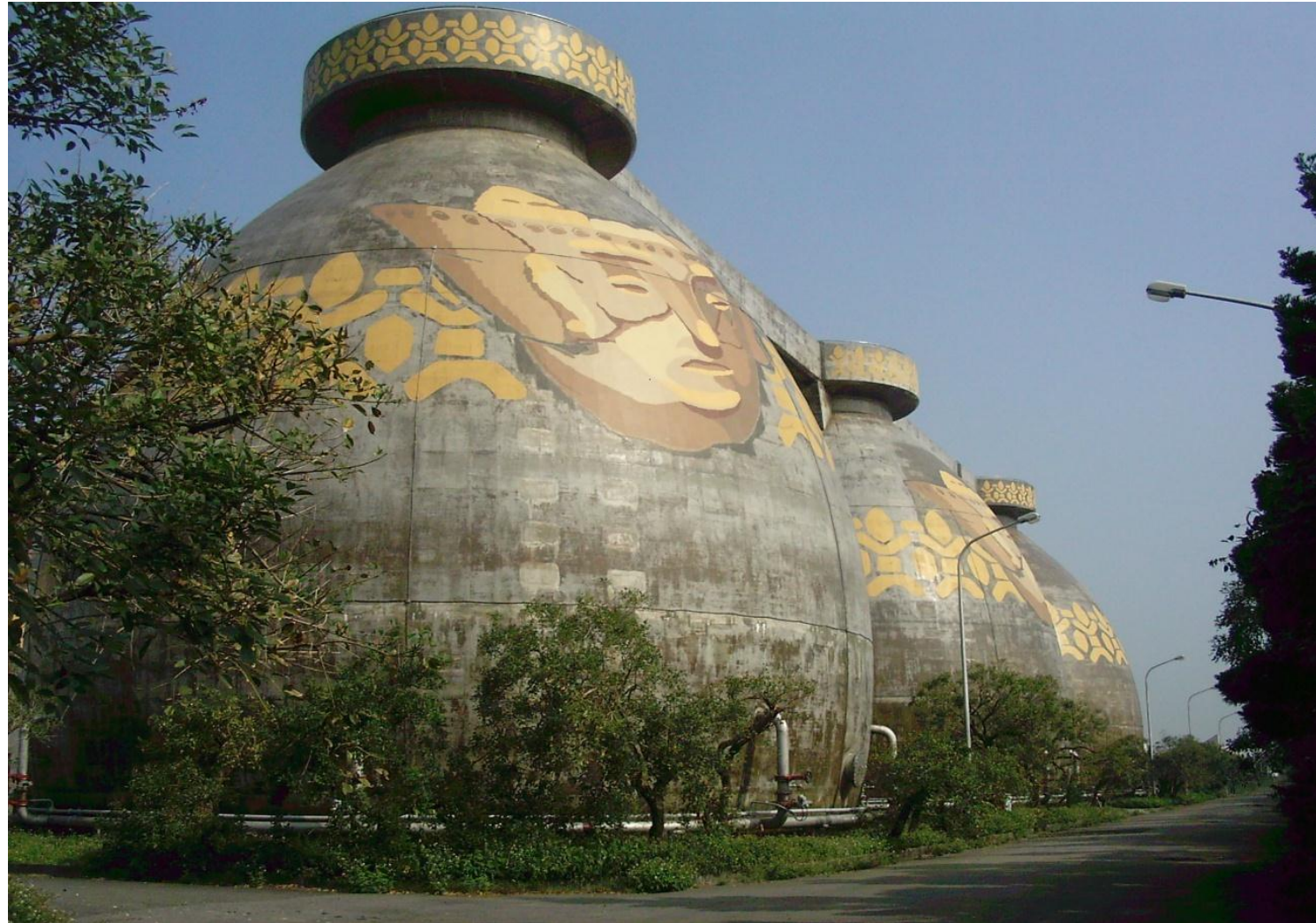
圖4.八里廠蛋形消化槽
