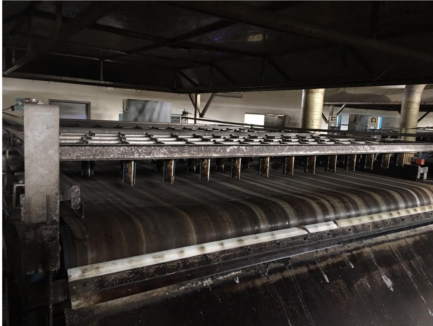
圖6.迪化廠污泥濃縮處理設備
